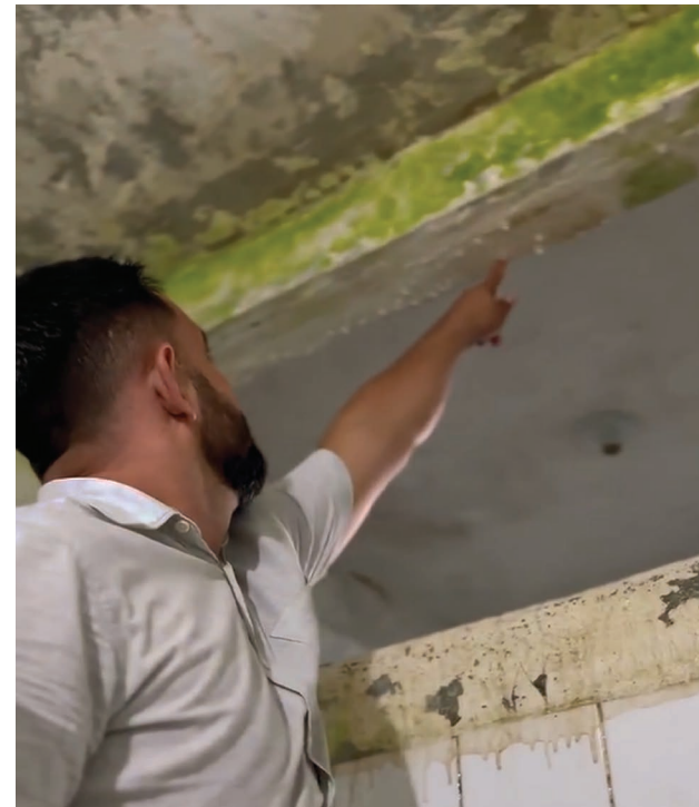
O vereador Wellington Silva mostra o estado deplorável do banheiro feminino da escola, que chocou a população
