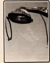
Uma das luminárias destruídas
