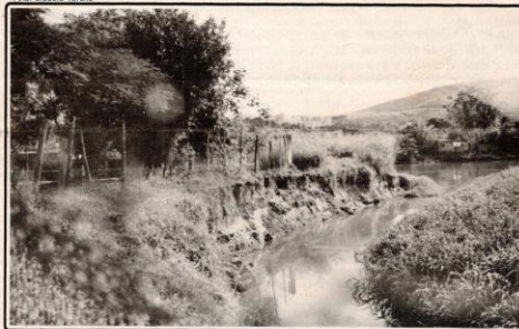
EROSÃO - O caminho de passagem entre a rua Carlos Pinto e a rua Silva Caldas (rua em frente à Quadra Cobera) está em processo de erosão. O local margem o Parque Ecológico Nelson Lorena, que teve seu alambrado recuado para que a erosão não o derrubasse. O "caminhinho", como é vulgamente conhecido, era usado pelos pedestres como atalho entre o centro da cidade e o bairro da Margem Esquerda.
